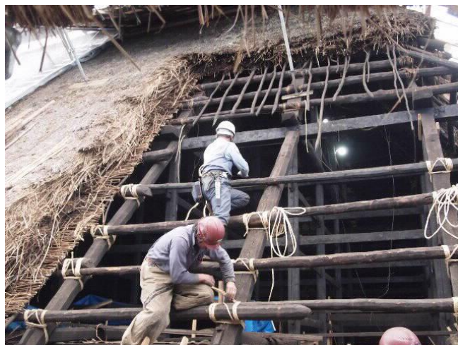
戸隠での茅葺き屋根の葺き替え工事 当会で採取したカヤが使われます。
