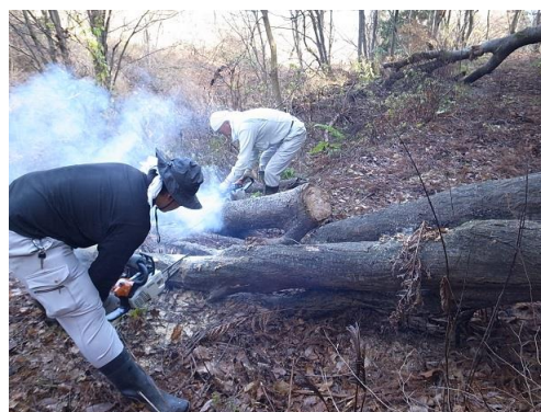
倒木の撤去作業
