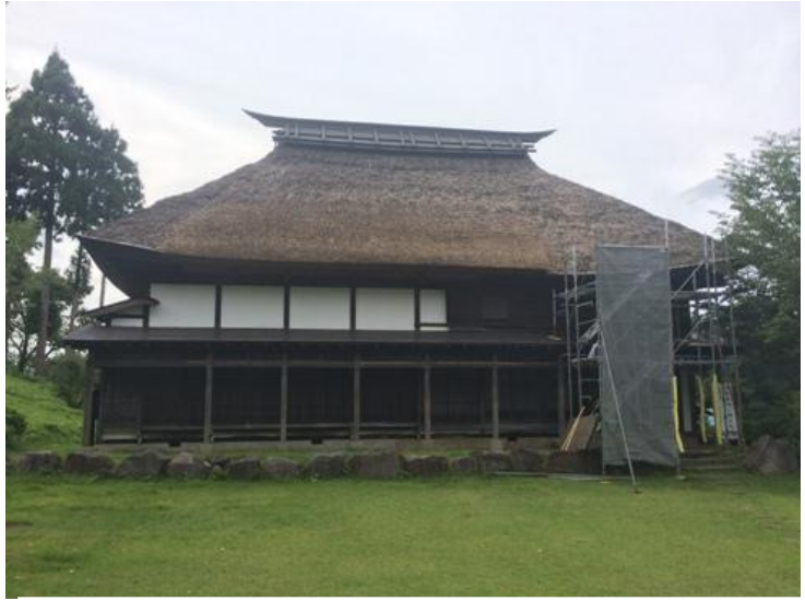
当会で採取したカヤにより「かやぶき屋根」を修復中の北竜湖資料館
